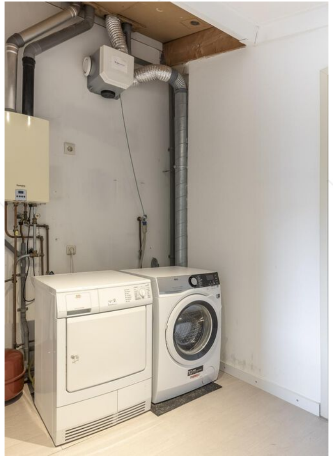
Witgoedaansluitingen overloop 2e verdieping
