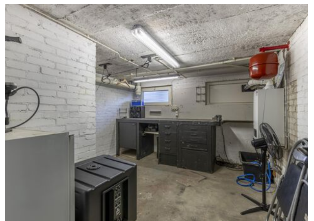
Inpandige berging met C.V.-opstelling
