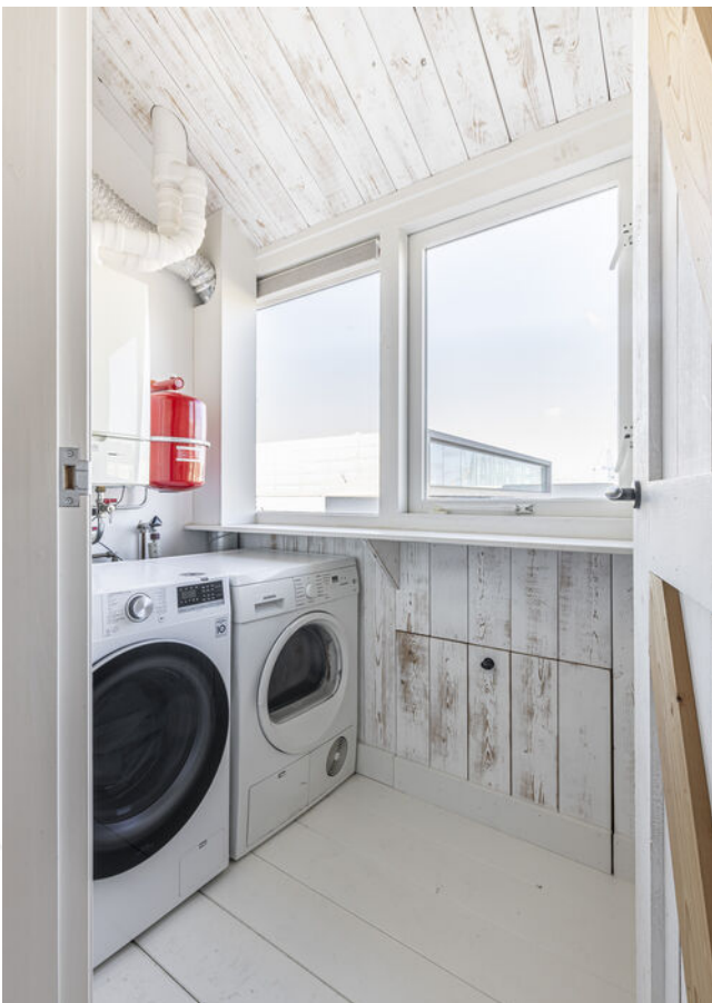
Wasruimte (o.a. met cv-ketel en witgoedaansluitingen)
