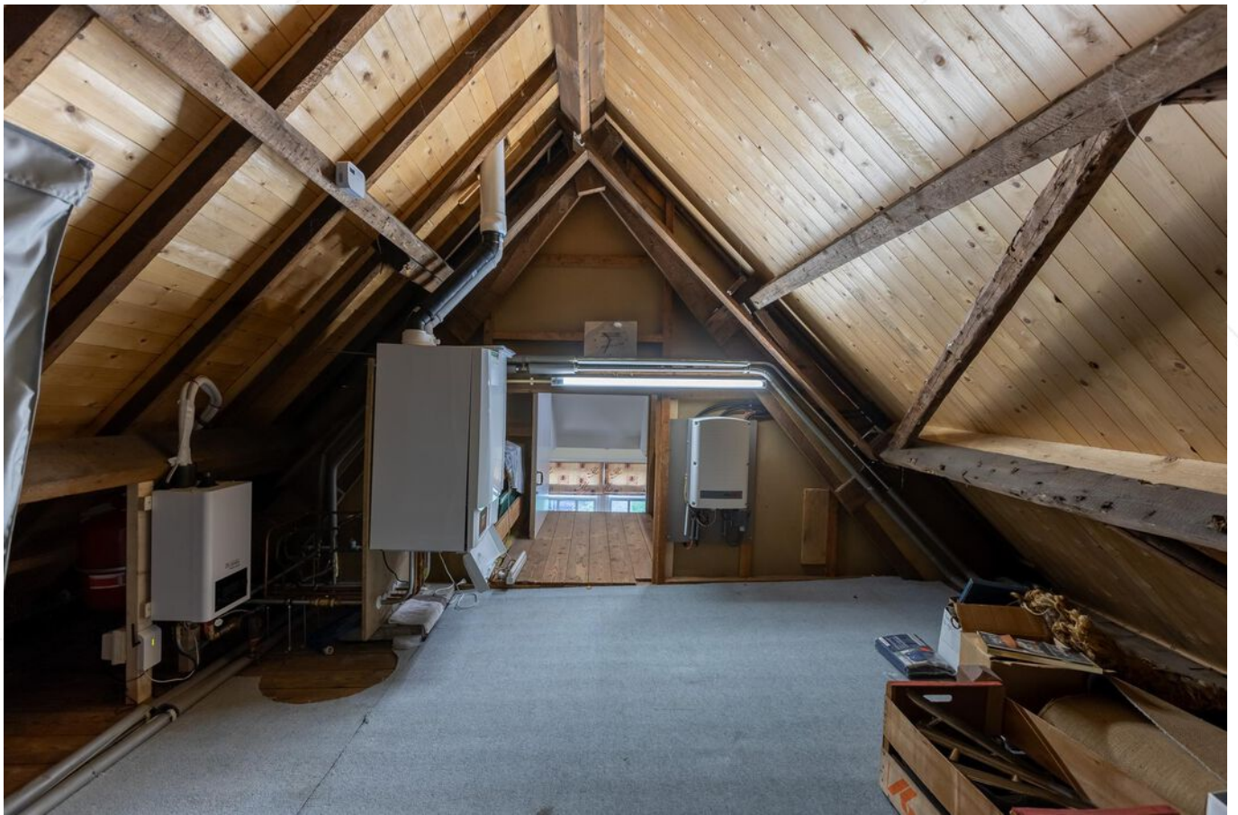
Zolderverdieping met o.a. de cv-ketel
